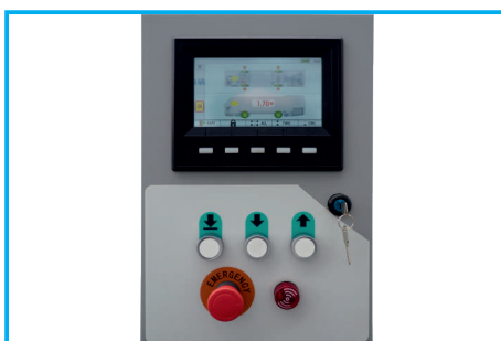
PAINEL DE CONTROLO
